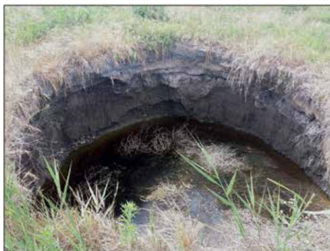
Figura 10. Ejemplo de colapso por combustión de la turba (nº25, Camino Moledores). Figure 10. Example of collapse by combustion of peat (nº25, Camino Moledores).
