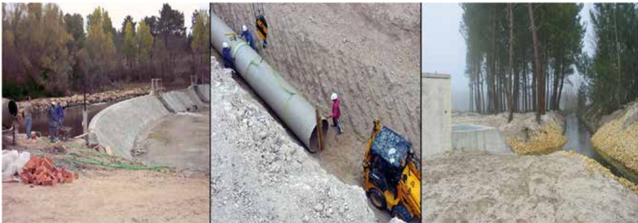
Fotografías 1, 2 y 3. Azud de derivación del río Cega, tubería de distribución y punto de suelta. Photographs 1, 2 and 3. The Cega River dam, distribution pipe and output point.
