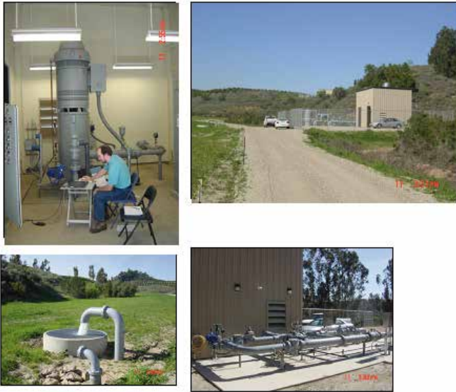
Figure 6. ASR well facilities and the setting of the well. Figura 6. Instalaciones de ASR y trabajo en el campo.
