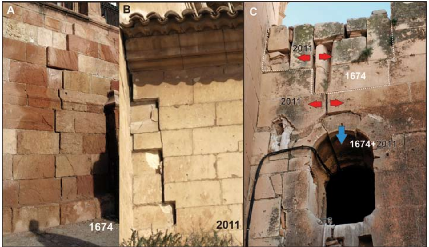
Figura 11. EAes reactivados con el terremoto de 2011. Desplazamientos en la horizontal de bloques de sillería del muro SE (dirección del muro: N055°E) de la Colegiata de San Patricio generados por: A) el terremoto de 1674 y B) por el de 2011. C) Deformaciones sísmicas en uno de los contrafuertes de la nave central de la Colegiata de San Patricio (dirección del contrafuerte: N145°E). La línea de puntos marca una reparación con elementos anómalos tras el terremoto de 1674. Se pueden observar grietas afectando a estas reparaciones y la reactivación de la caída de la clave del arco por el terremoto de 2011.
