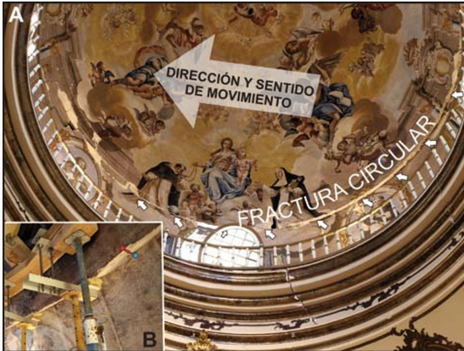
Figura 10. Fractura horizontal de la cúpula de la Iglesia del Paso Azul, en el límite de la cubierta de hormigón añadida en restauraciones recientes. A) La flecha blanca indica la dirección de movimiento de la cúpula hacia los N330°E. B) Detalle del vector desplazamiento de la cúpula de 14 cm hacia los N330°E.
