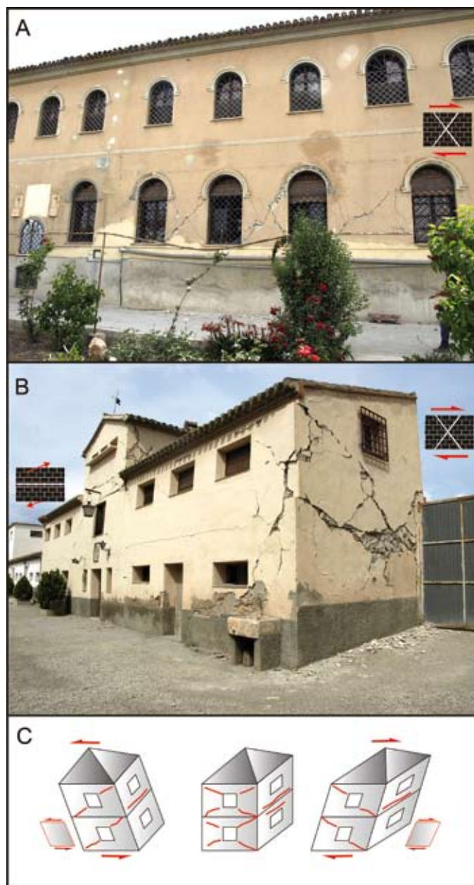
Figura 5. Fracturas en los muros del Convento de las Clarisas: A) fracturas conjugadas en un muro de orientación N150°E; B) fracturas conjugadas en muros N150°E y paralelas a la horizontal en muros perpendiculares, y C) esquema sintético de la génesis de fracturas conjugadas debido a los esfuerzos de cizalla cíclicos generados por el paso de ondas sísmicas superficiales.
