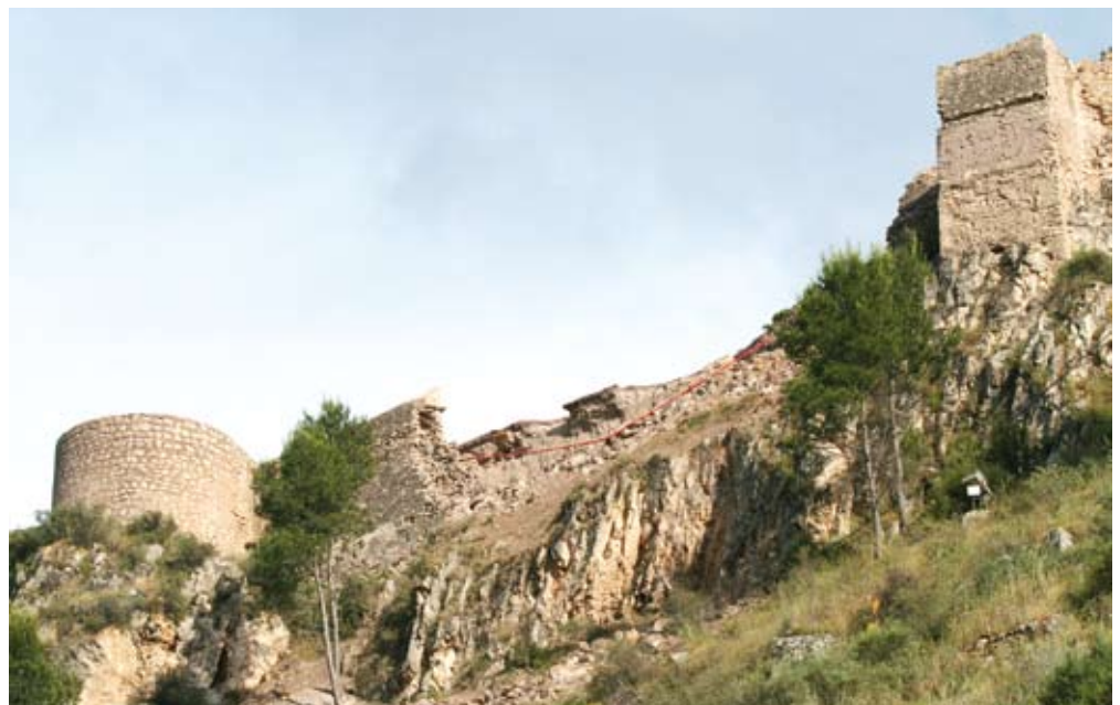
Figura 2. Desplome del lienzo de muralla del Castillo de Lorca.
