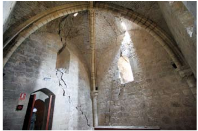
Figura 17. Agrietamiento de bóvedas de ladrillo y desplazamiento de muros interiores en el primer cuerpo de la Torre del Espolón.
