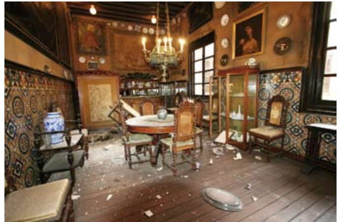
Figura 6. Rotura de piezas cerámicas por vuelco en el comedor del Palacio Guevara. Figure 6. Broken ceramics fallen to the ground in the dining room of the Guevara palace.
