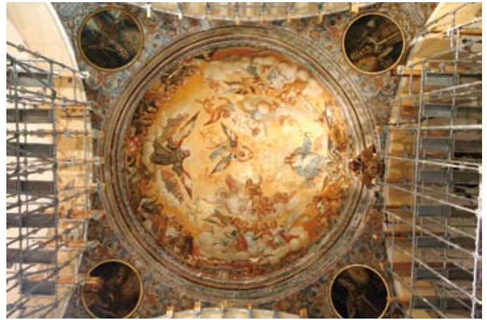
Figura 13. Agrietamiento horizontal de la cúpula de la Iglesia Virgen de las Huertas.
