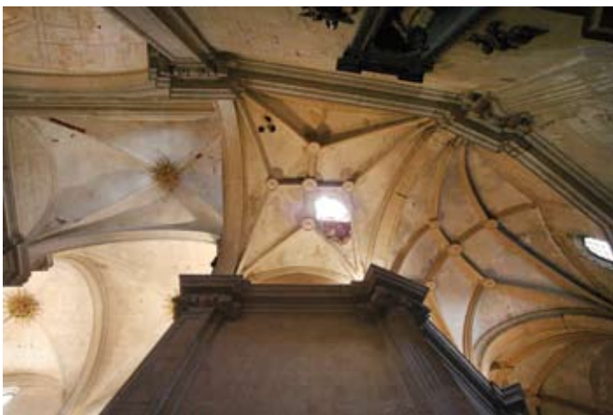
Figura 9. Perforación de las cubiertas de la girola de la Colegiata de San Patricio por desplome de los florones de cubierta de la torre.
