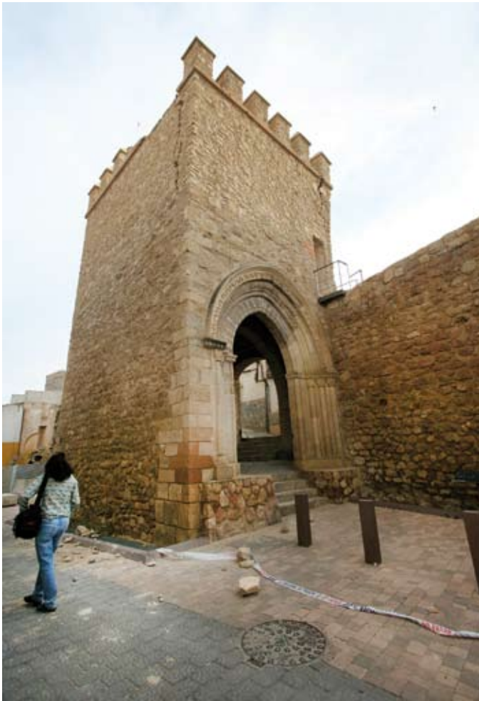
Figura 5. Desplome de almenas y grietas en esquinas en el Porche de San Antonio. Muralla de Lorca. Figure 5. Fallen merlons and cracked corners in the porch of San Antonio, Lorca city wall.
