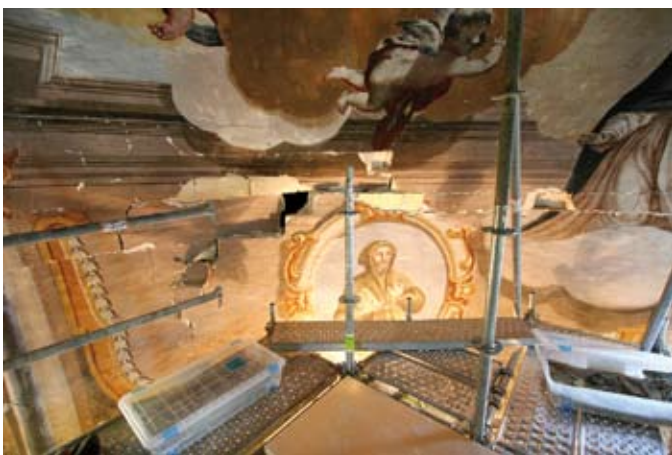
Figura 12. Grietas en la hoja interior de la cúpula de la Capilla del Rosario con pérdida de la decoración pictórica.
