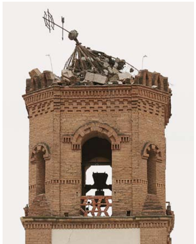
Figura 14. Desplome de la estructura de hormigón del cupulín de la torre de la Iglesia Virgen de las Huertas.
