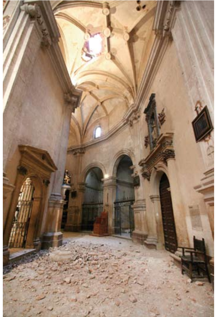
Figura 4. Rotura de la plementería y nervios de las bóvedas de la Colegiata de San Patricio con rotura del pavimento en la zona de impacto.
