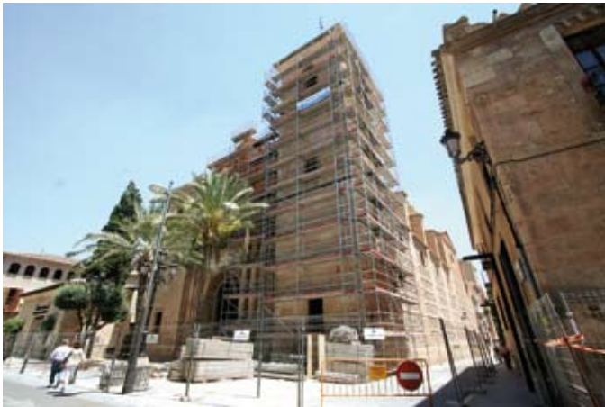
Figura 30. Obras de emergencia en la Iglesia de San Mateo. Figure 30. Emergency work on the church of San Mateo.
