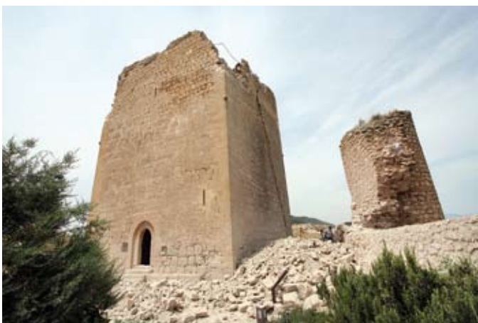
Figura 16. Desplome de parte de la coronación de la Torre del Espolón. Castillo de Lorca.
