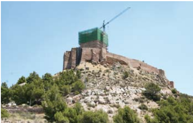
Figura 32. Obras de emergencia en la Torre del Espolón Castillo de Lorca. Figure 32. Emergency work on the Spur tower, Lorca castle.
