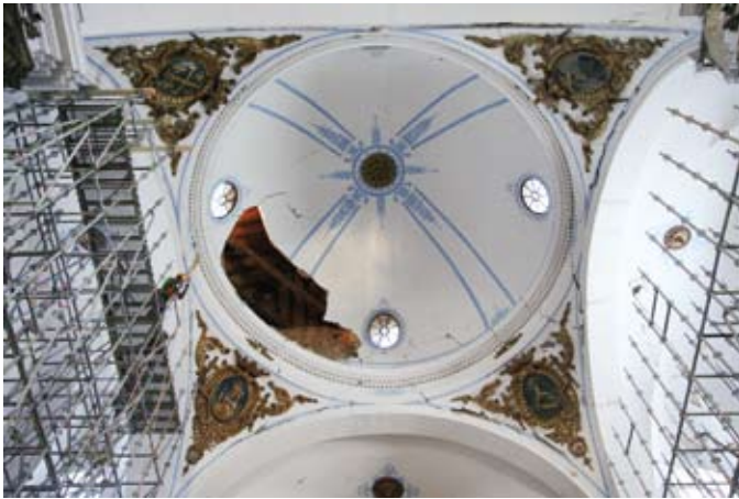
Figura 15. Rotura de la cúpula de la Iglesia de San Francisco con pérdida de parte de la bóveda tabicada.
