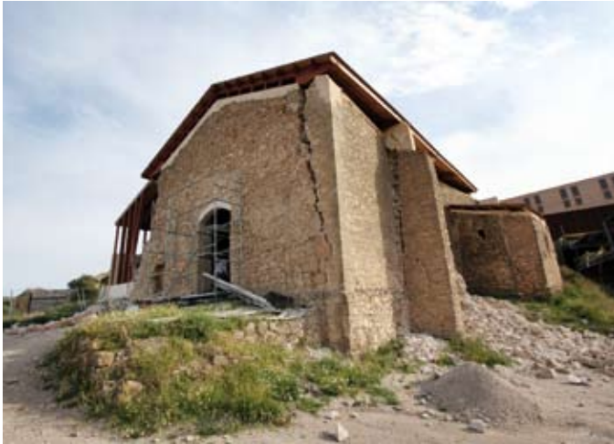
Figura 3. Daños en la Ermita de San Clemente. Castillo de Lorca. Figure 3. Damage to the San Clemente hermitage, Lorca Castle.
