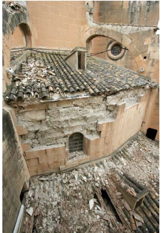
Figura 10. Desplome de la cara exterior del muro de cierre NE de la girola de la Colegiata de San Patricio sobre las cubiertas.
