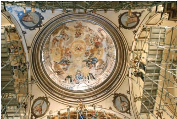
Figura 11. Agrietamiento horizontal de la cúpula de la Capilla del Rosario a la altura de la zona superior de los óculos.
