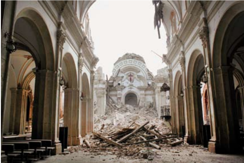
Figura 8. Ruina completa del crucero de la Iglesia de Santiago.
