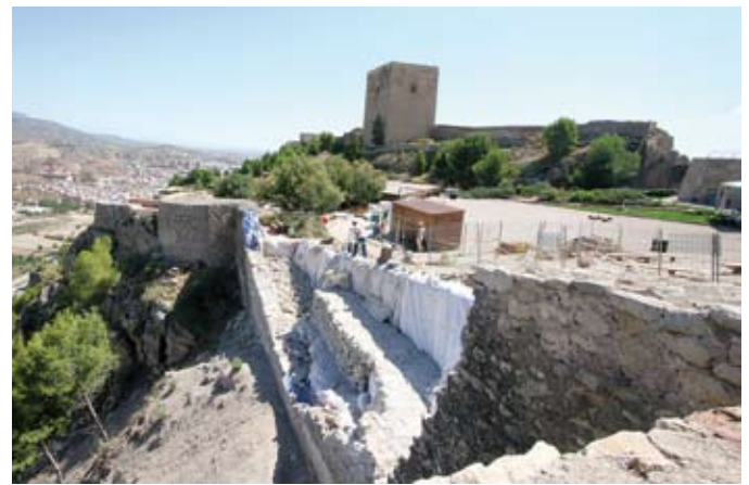
Figura 22. Obras de consolidación con supervisión arqueológica en lienzo desplomado del recinto amurallado del Castillo de Lorca.
