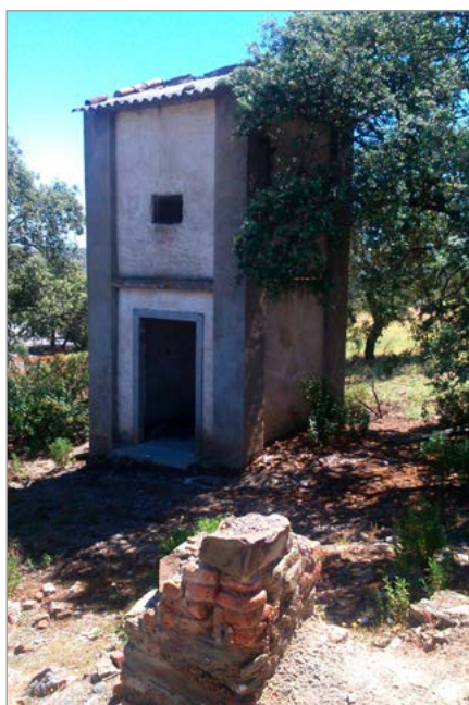
Fig. 49. Caseta del transformador próxima a la planta de lavado de los años 50. Foto: R. Jiménez (abril 2017).
