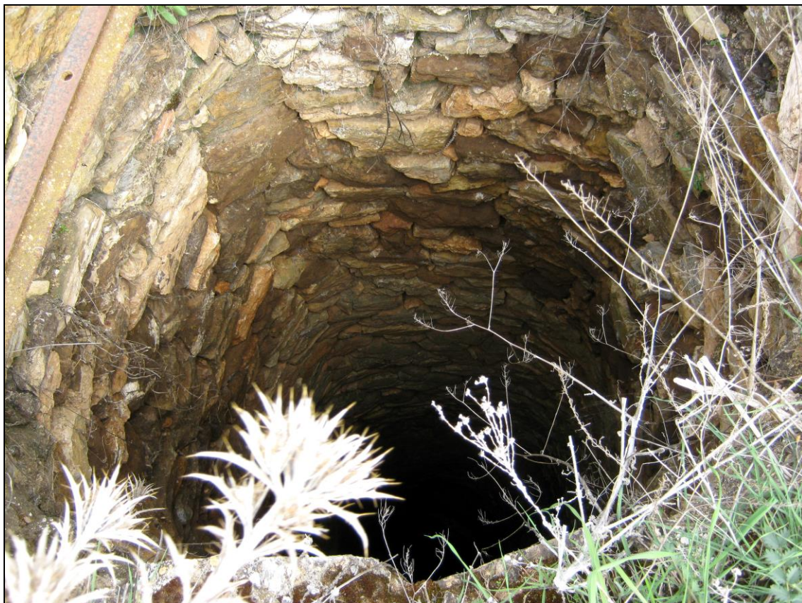
Figuras 46: Pozo de mampostería con sección circular en el Punto 11 de las labores localizadas.
