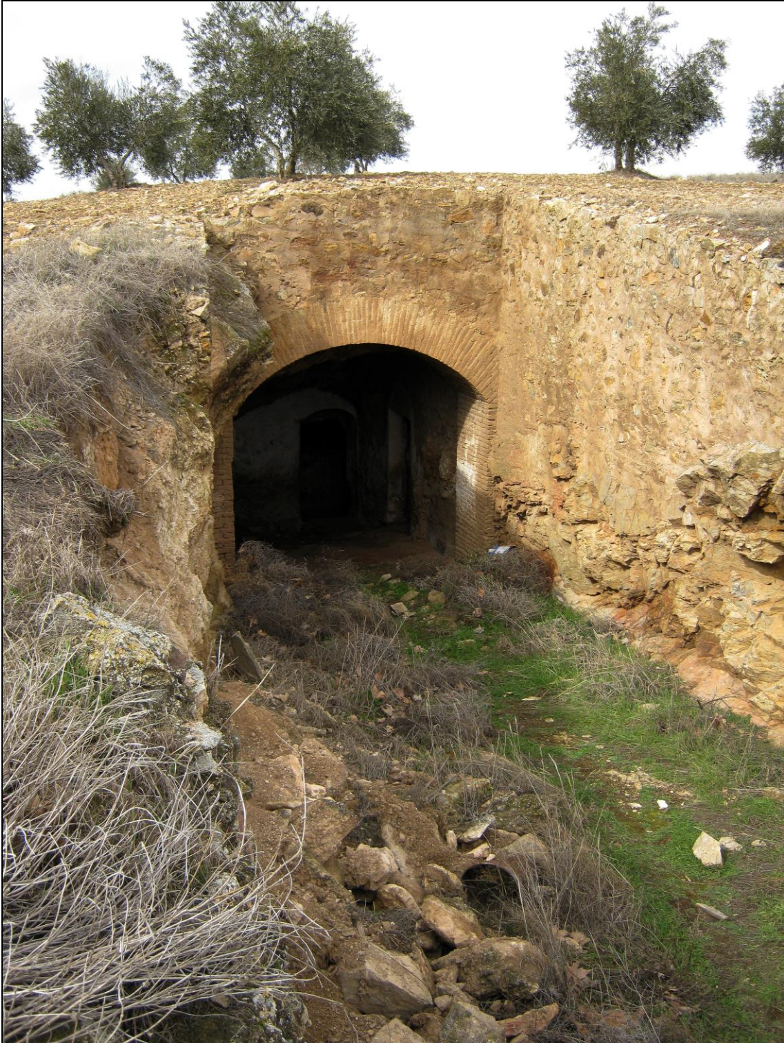
Figura 52: Entrada al socavón que está 50 m al N de la "Majada de Desiderio" en el Punto 15.
