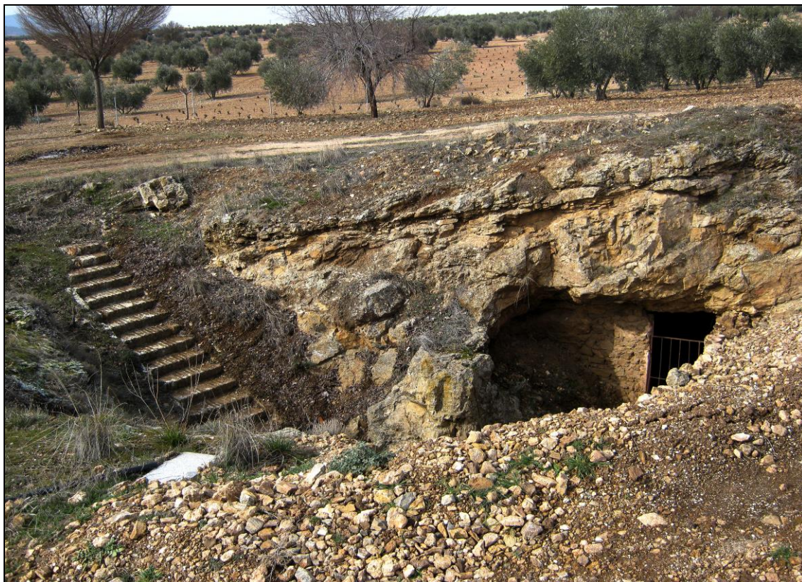
Figura 58: Socavón dentro del recinto vallado de la "Majada de Desiderio" en el Punto 15.
