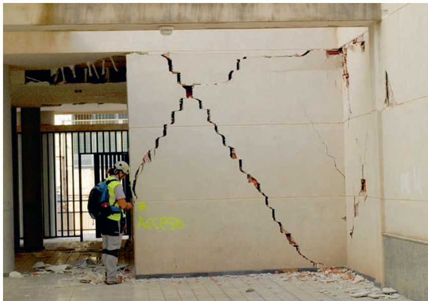
◀ Figura 56. Terremoto de Lorca (Murcia) (5,1 Mw), ocurrido el 11 de mayo de 2011. Estudio de daños orientados en una construcción contemporánea. Fotografía: Miguel Ángel Rodríguez Pascua.
