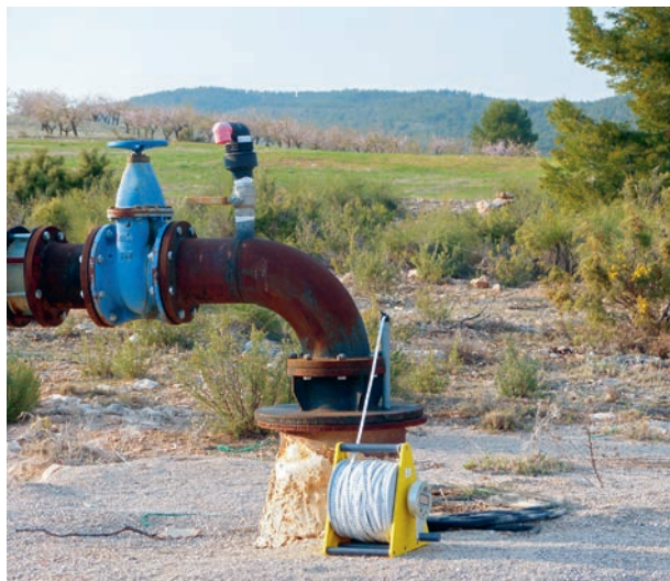
Figura 1. Piezómetro de control de la red oficial en la masa de agua subterránea Alcadozo (Albacete). Fotografía: Jorge Hornero.
