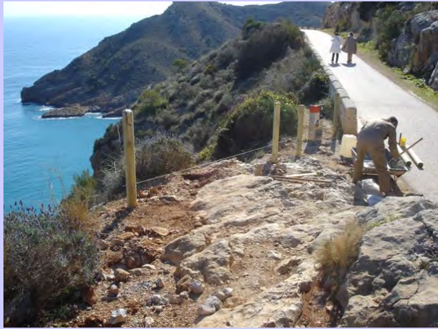
Figura 51: Construcción de vallado de seguridad en el acceso a uno de los miradores de la ruta del Faro del Albir (L'Alfàs del Pi) Fuente: Archivo fotográfico del Parc Natural de la Serra Gelada
