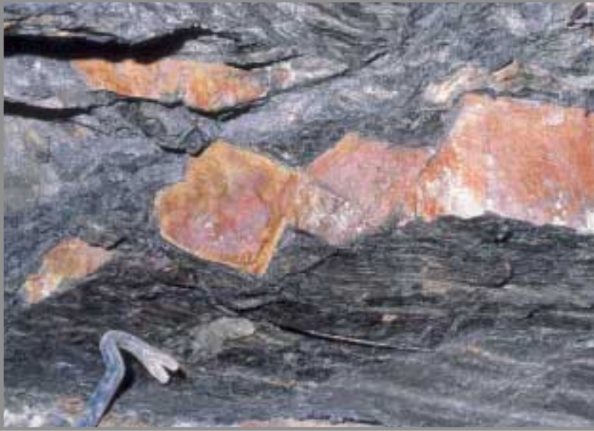
FOTO 3.- Mina del Pozo, Planta 1ª de la Mina de Almadén. Cizallamiento de capas alternantes de cuarcitas y pizarras producidos en una importante fractura que pone en contacto la "Roca Frailesca" con las alternancias del techo de la Pizarra de Muro. Estos ejemplos merecen el calificativo "de libro" en cuanto estructuras de deformación por cizalla en alternancias de rocas de desigual competencia (multilayer).
