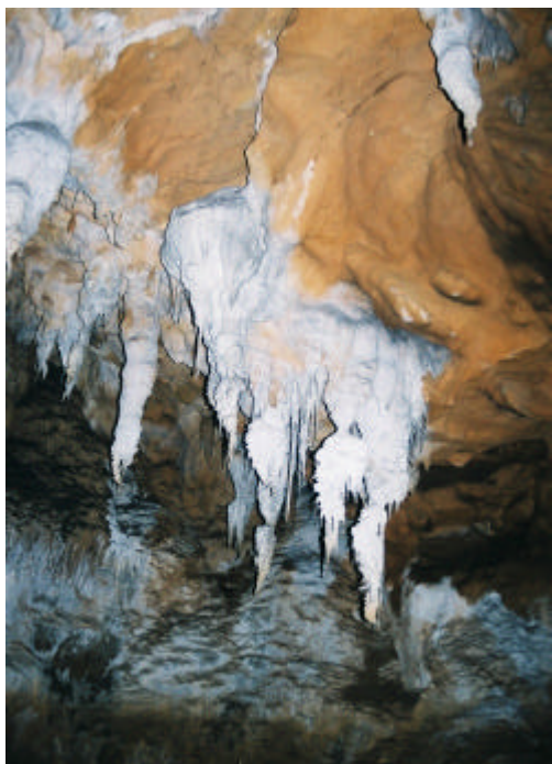
Foto 46 Estalagmitas irregulares en el techo del tramo 13
