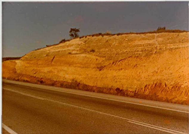
AG.758. TALUD EN LA CARRETERA NACIONAL 330, REALIZADO SOBRE DEPOSITOS AR CILLOSOS Y CONGLOMERATICOS DEL MIOCENO SUPERIOR-CUATERNARIO ( T_{c12}^{Bc1} -Q11).
