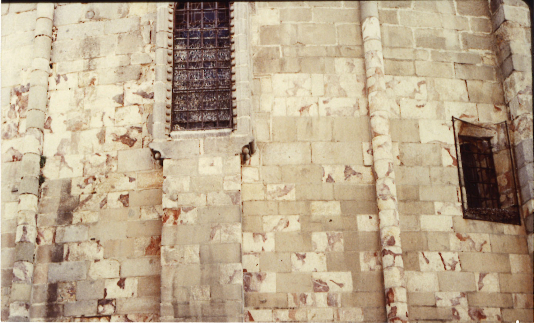
PIG-2(7). Abside de la Catedral de Avila construido con estos materiales con alteración ferruginosa.
