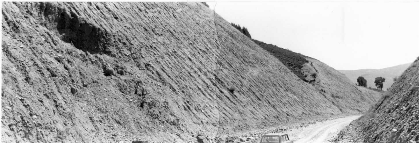
Otro aspecto de las trincheras de la futura cra. nacional de Orense, excavadas en la formación terciaria, detrítica, roja, acarvacada y con problemas de deslizamientos locales. (T Bas ) Estación 1035 a
