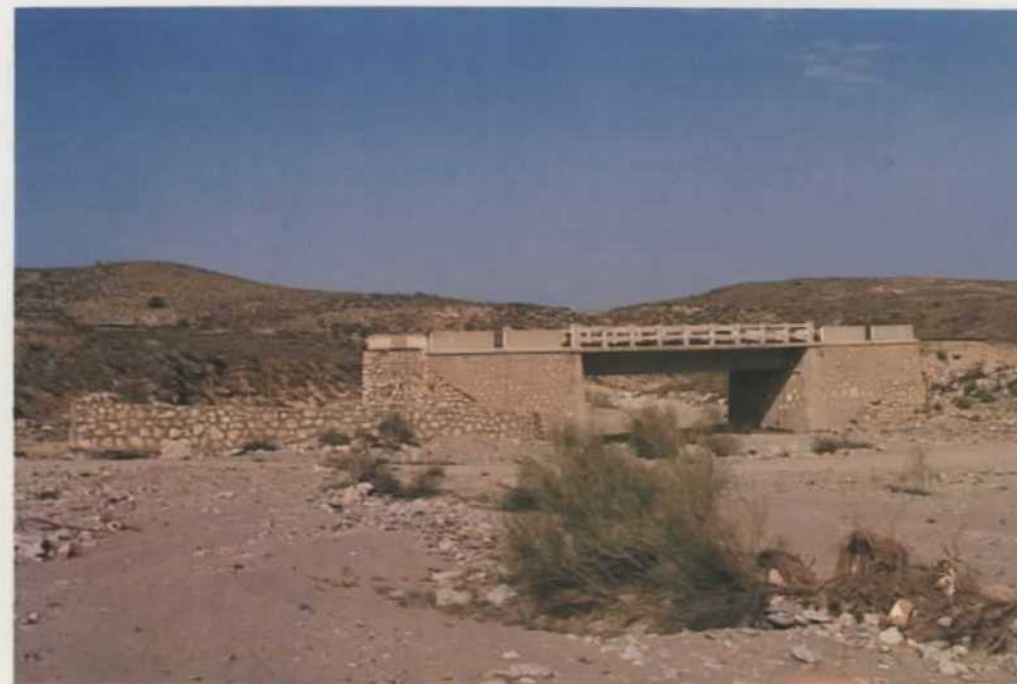
Las lluvias torrenciales, típicas del clima mediterráneo, causan daños en las construcciones y vidas humanas. Dos ejemplos de ello son estos aislados puentes en las ramblas del Serrón, arriba, y Gochar, cerca de Sorbas.
