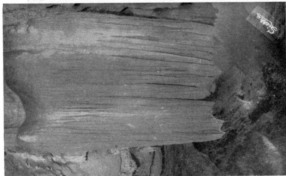
13.—Coladas pendientes de las antiguas conducciones hídricas en la bóveda (fot. J. Sierra).
