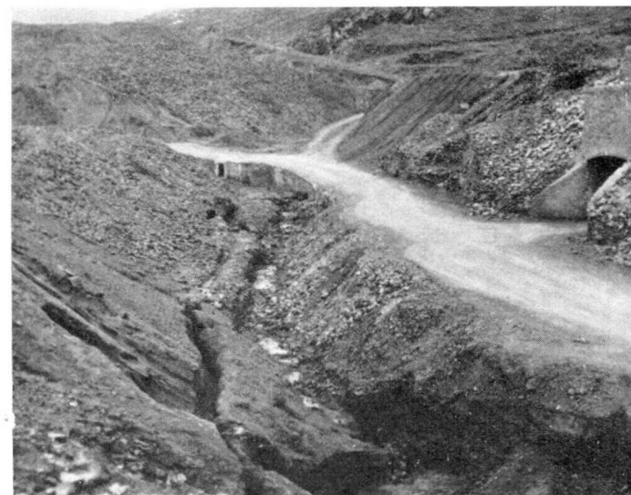
Foto 2.—Curso aparente de la rambla de Mendoza por la cuneta de la carretera. A la izquierda grieta por la que las lluvias seguirán socavando la escombrera.
