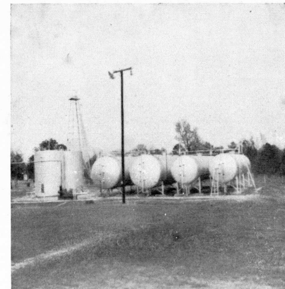
Separadores de gas y petróleo.
