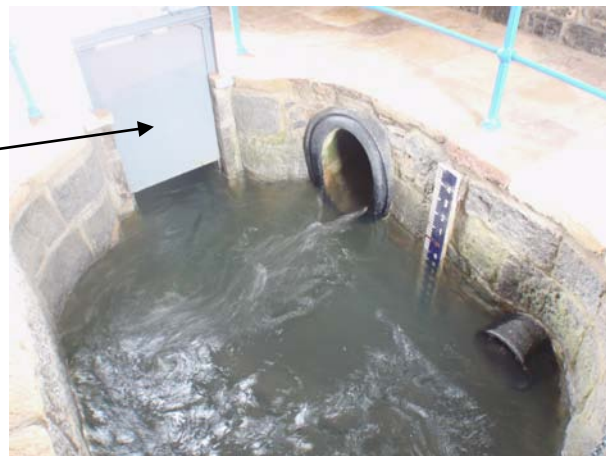
Fotografía 17.- Detalle de la compuerta que dirige el agua al desarenador.
