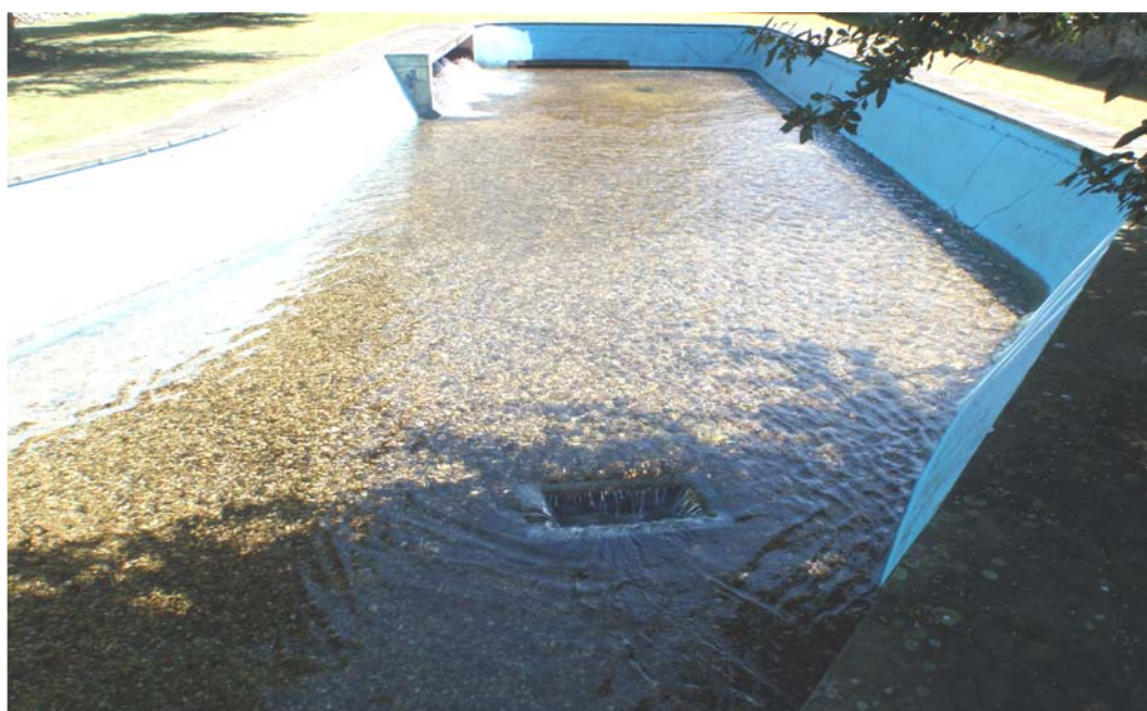
Fotografía 11.- Sumidero en el fondo de la balsa de La Sovilla.
