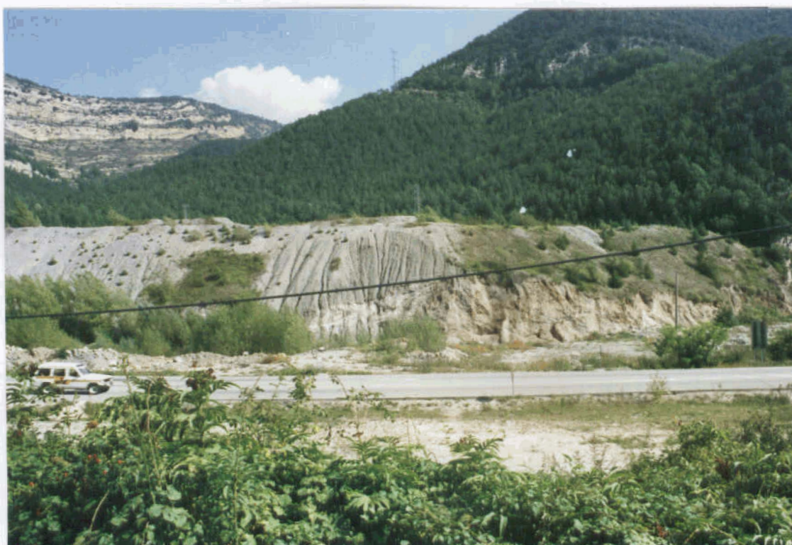
Foto núm. 8. Erosión de taludes y, a la derecha, socavación debida a avenida del río Llobregat en la escombrera 36-11-5-10.
