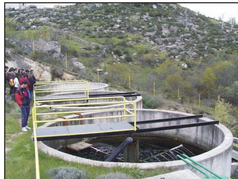
Figura 15: EDAR de El Berrueco.
