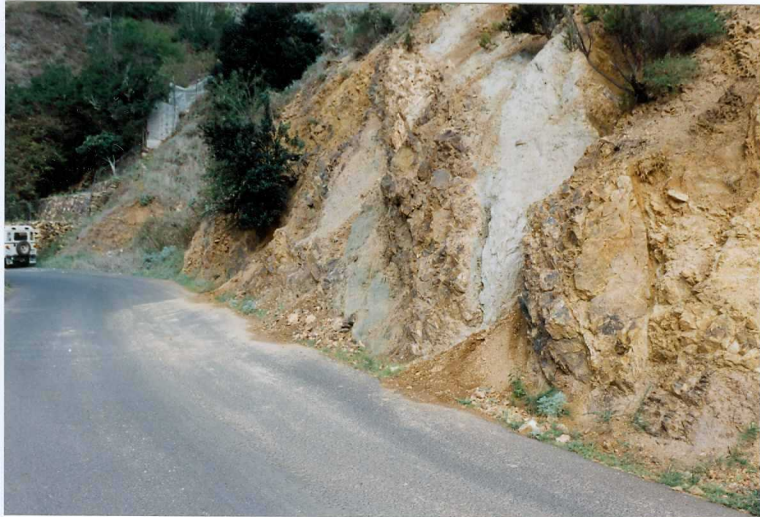
Fot.nº65.- Detalle de pequeños conos de derrubios producidos por la acción de las lluvias. Además se producen numerosas caídas de piedras debido a la intensa trituration e inyección filoniana. Crtra. Vallehermoso a Los Chorros de Epina.
