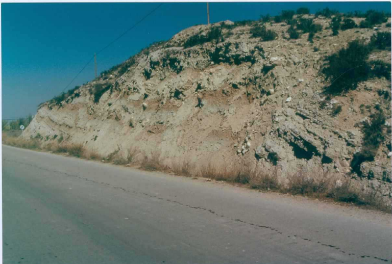
Foto 6.- Deformaciones junto al pueblo de Rodén (punto de observación nº 6) afectando al tramo yesífero-arcilloso rojo (unidad 14) de la Unidad Bujaraloz-Sariñena. Se observan colapsos de yesos y numerosas fallas normales de pequeño salto.
