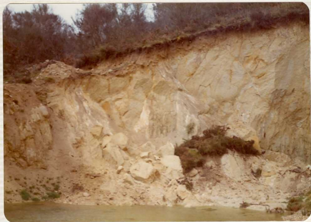
730.- Procesos de desprendimiento en talud de granito altera- do.
