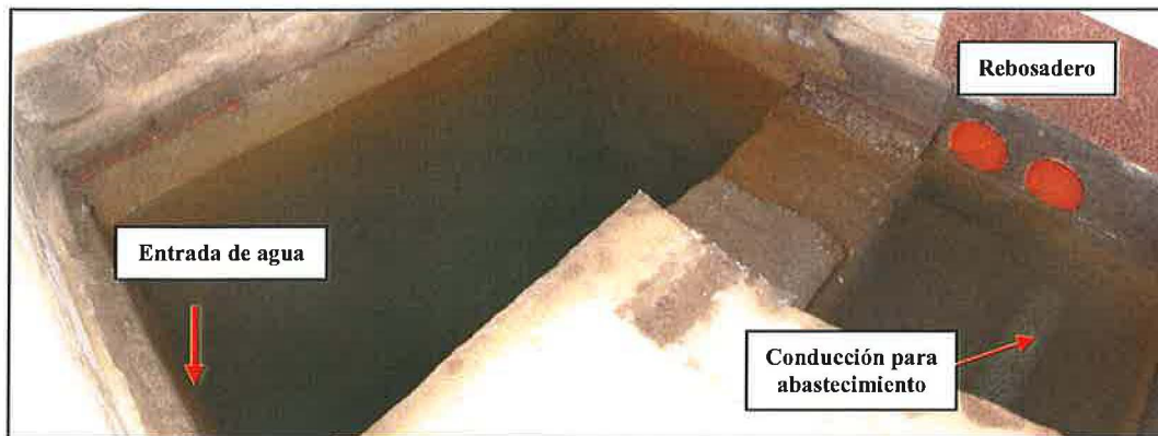
Figura 10.- Interior de la captación para el abastecimiento a Beberino
