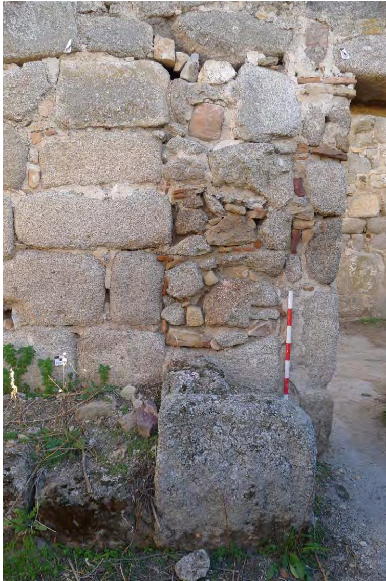
Fig. 5. Arranque del muro oriental de la habitación norte perdida
